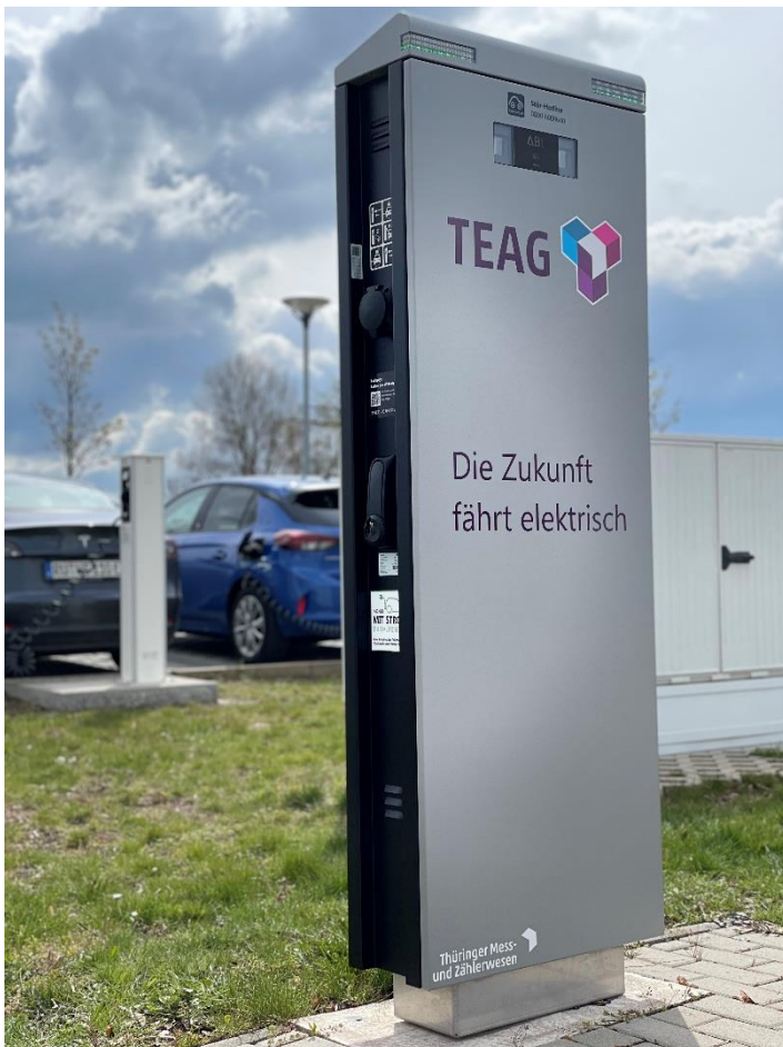
Abb. 1: Die ABL-Ladesäule eMC3 auf dem TEAG Campus wurde erfolgreich an das PPC Smart Meter Gateway angebunden (Bild: TEAG).
