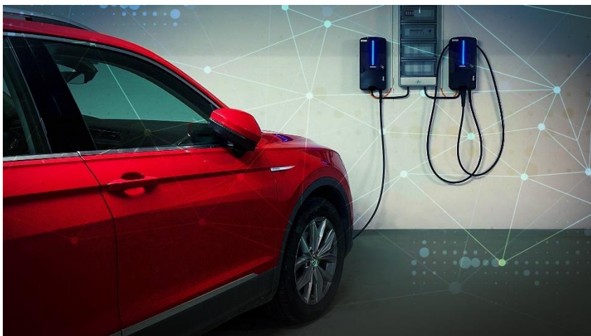
Abb. 1: Für das Management von Ladesäulen wurden mehrere Ladesäulen von Webasto auf den Firmenparkplätzen von Robotron und deren Tochterfirma SASKIA an das intelligente Messsystem angebunden. Die Kommunikation erfolgt über Smart Meter Gateway und CLS Gateway von PPC. (Bild: Robotron Datenbank-Software GmbH/ SASKIA®)
